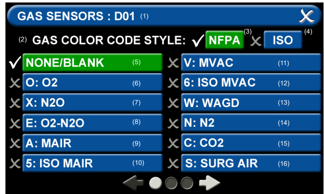
Figura 44: Pantalla de sensores de gas
